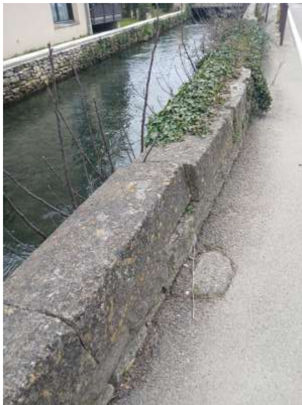
Basculement des maçonneries
