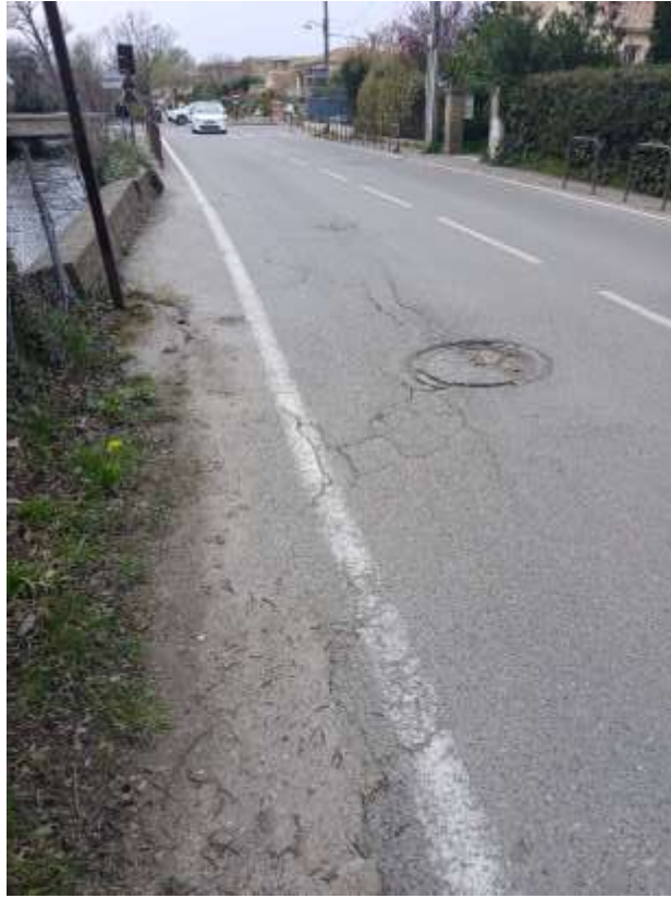
Affaissements de la chaussée
