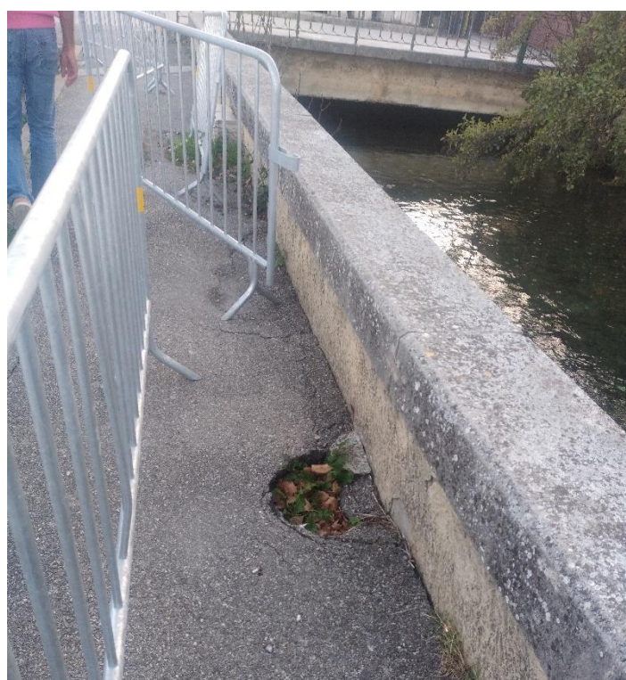
Affaissements et effondrements au droit des affouillements du mur
