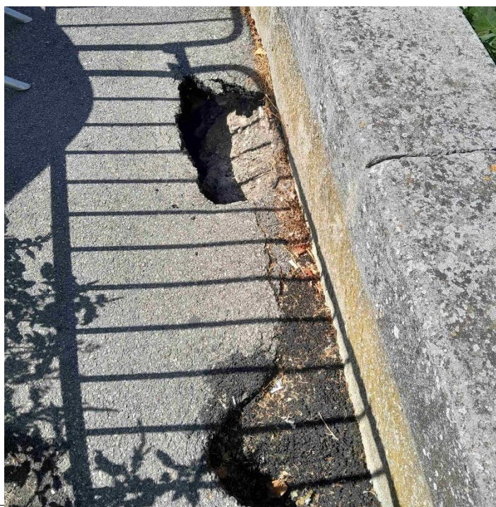
Effondrement de la chaussée au droit des affouillements du mur
