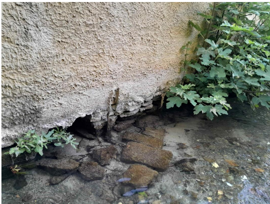
Affouillement en pied de mur-berge
