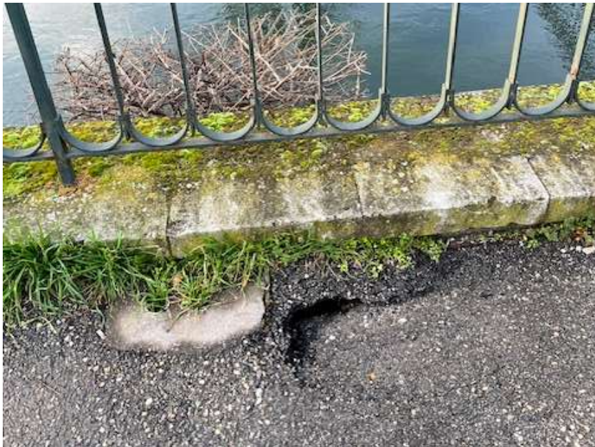
Effondrement de la chaussée au droit des affouillements du mur
