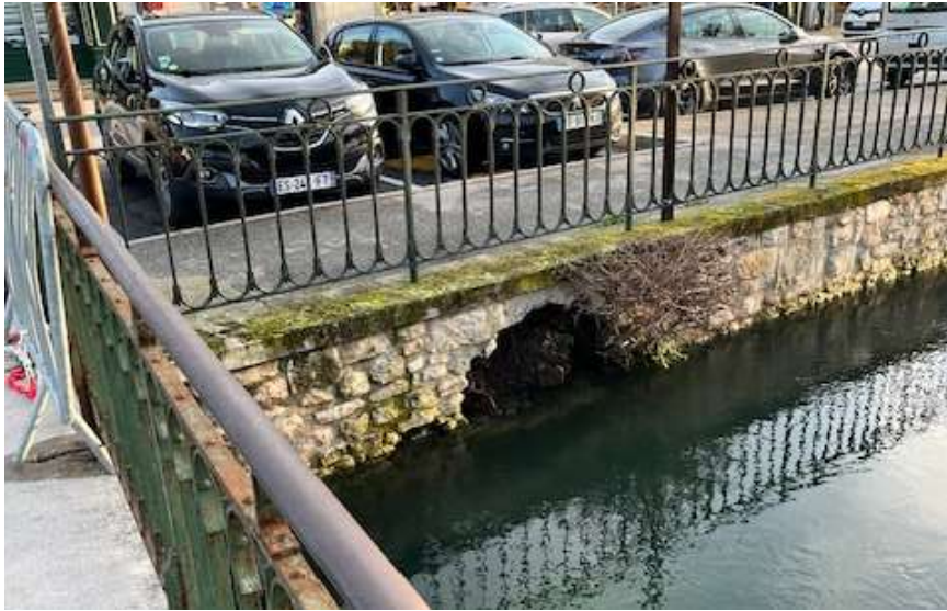
Effondrement du mur-berge
